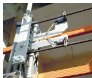
扉開閉リミットスイッチ
